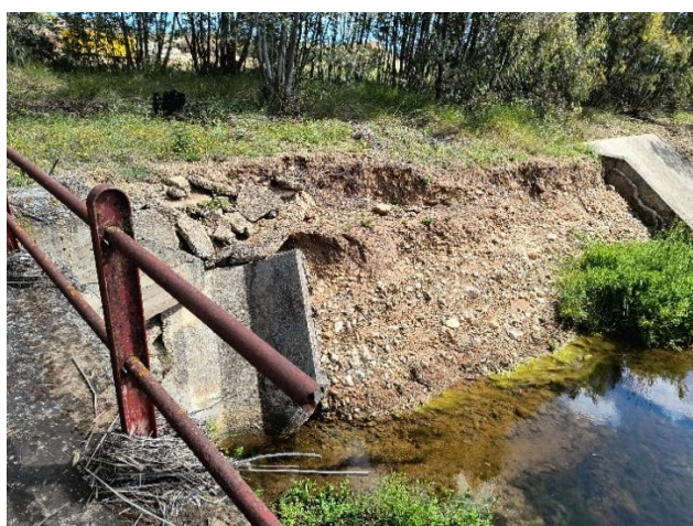
Figura 6 – fenomeni di erosione a monte del p.to di scarico
