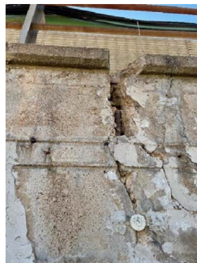
Figura 23 – Criticità strutturali nell'infrastruttura
