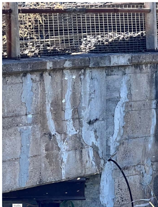
Figura 1: Criticità strutturale nell'opera
